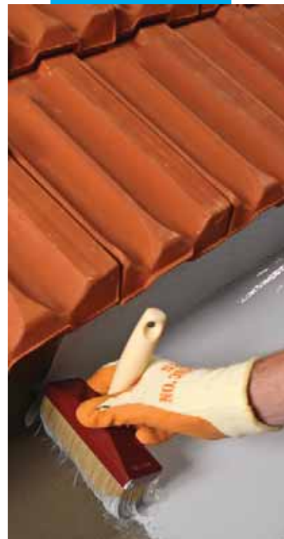
Atypický okapní žlab opatřený hydroizolací Mapelastic Smart s aplikací povrchové úpravy Elastocolor Waterproof
